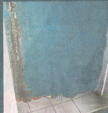
美景路熟食中心：厕所的门损毁，而且还有污迹。
