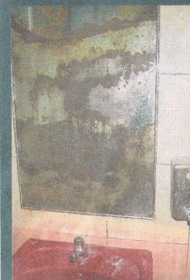
惹兰红山第112座熟食中心：镜子严重生锈，洗手盆有污迹，容器脏得没法用。
